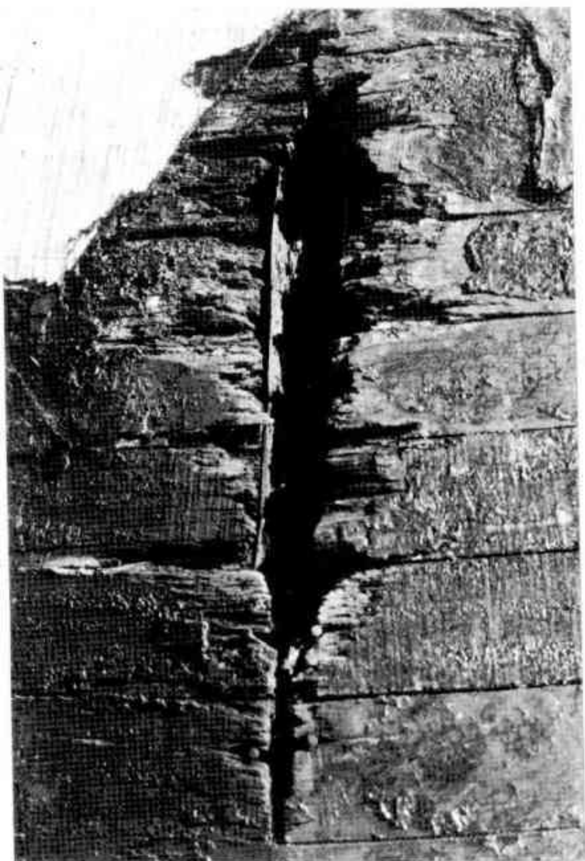
Foto 8: Así estaba el entablonado de la cúpula. Años de goteras lo habían destruido parcialmente.
